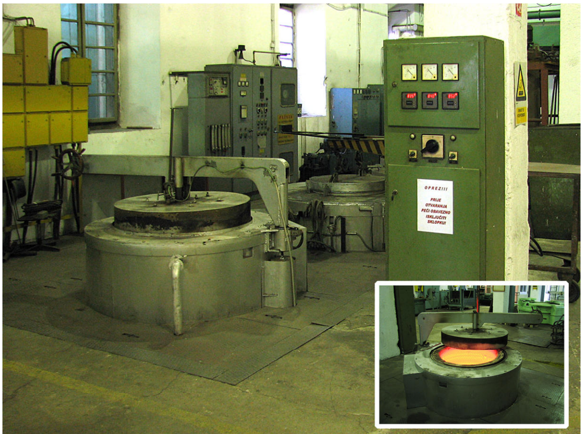
Slika 21. Peć za zagrijavanje pougljičenih obradaka
