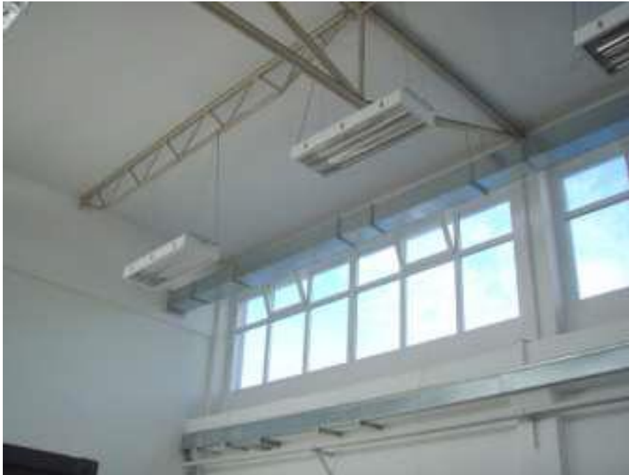
Slika 47. Odsisni kanali termoventilacije
