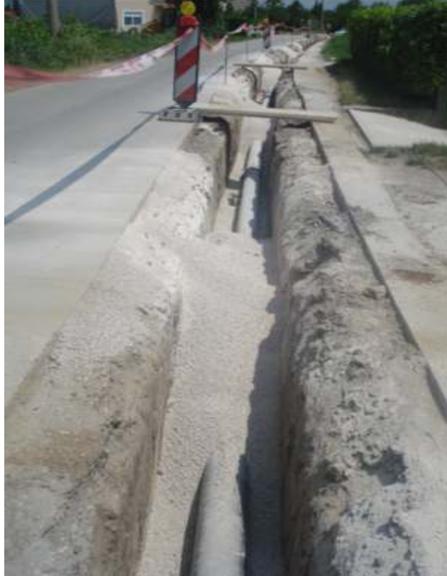
Slika 6.6.1. Primjer djelomičnog zatrpavanja rova [3]
