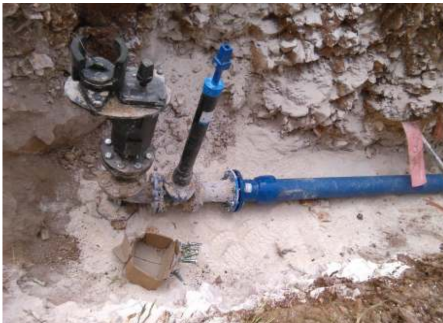
Slika 6.5.5. Kraj 4. čvora vodovodne mreže sa podzemnim hidrantom [3]
