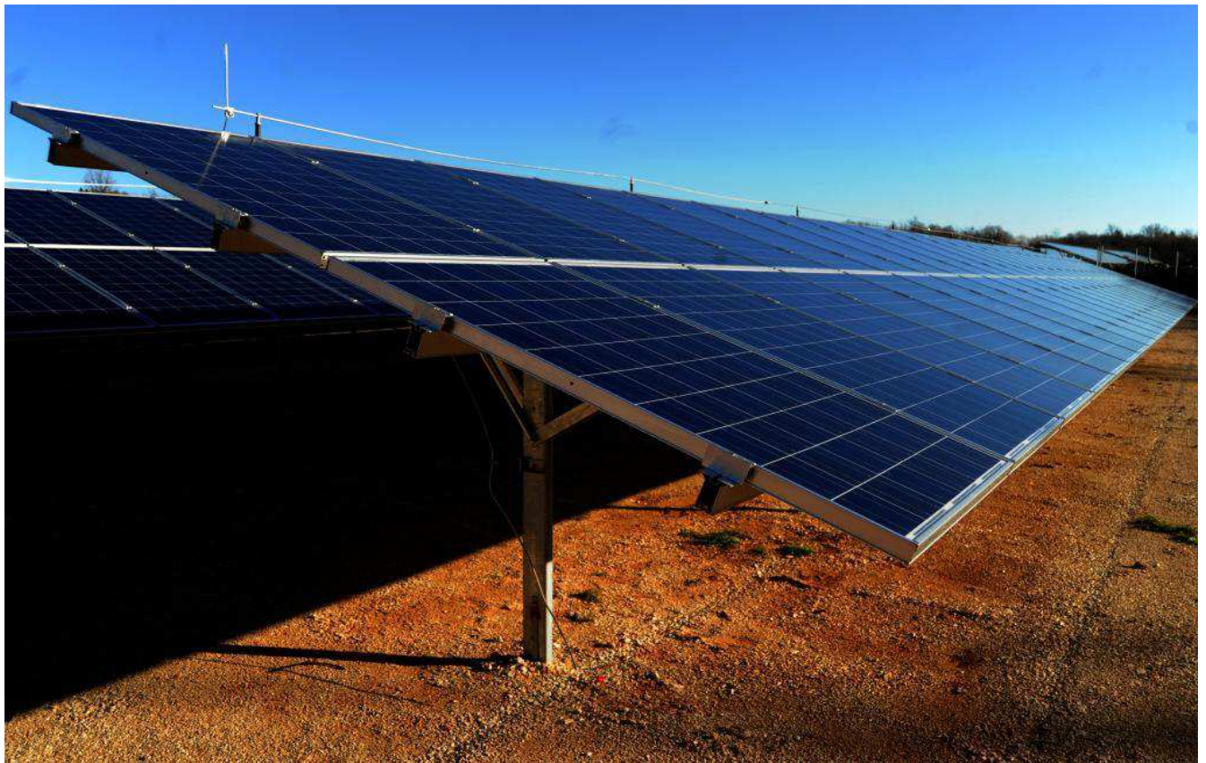
Slika 7.2.1 Solarna elektrana Kanfanar; Izvor: www.glasistre.hr
