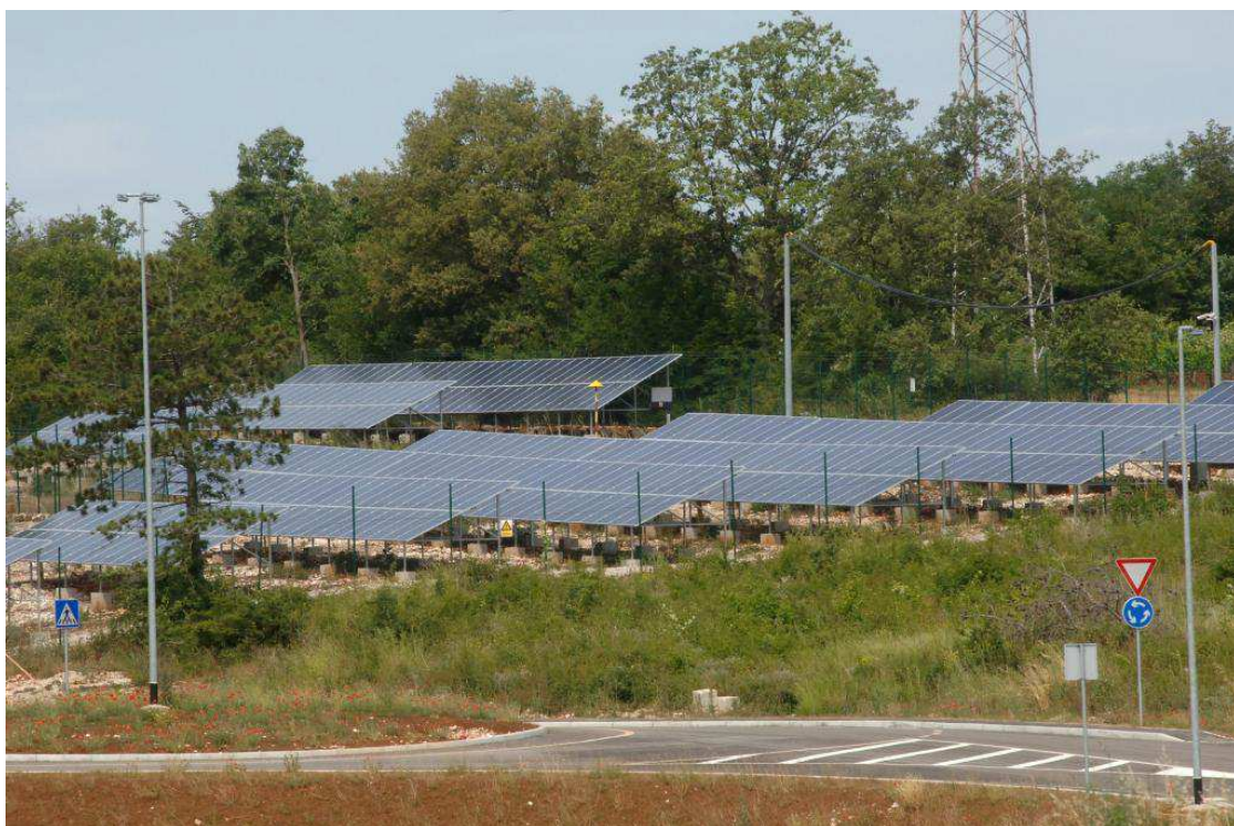
Slika 7.2.2 Solarna elektrana Barban; Izvor: www.glasistre.hr
