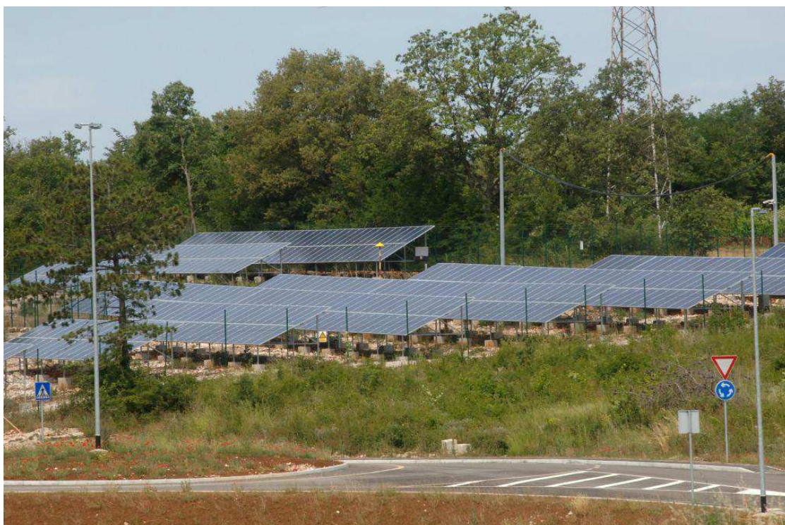
Slika 7.2.2 Solarna elektrana Barban; Izvor: www.glasistre.hr
