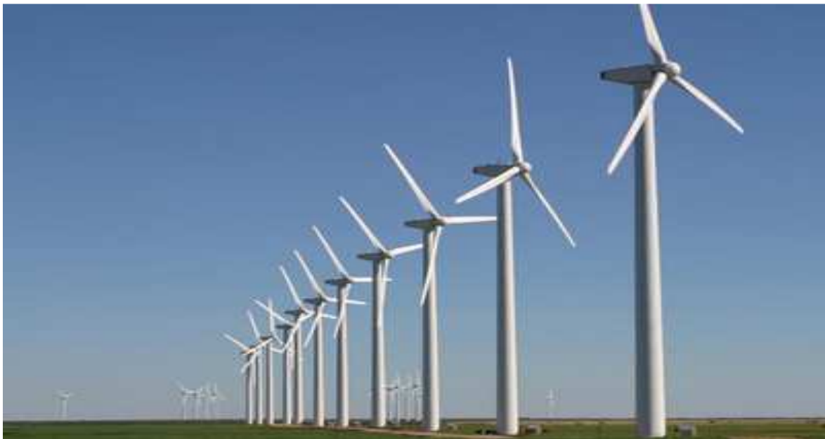
Slika 2.1 Vjetroelektrana; Izvor: www.metro-portal.hr
