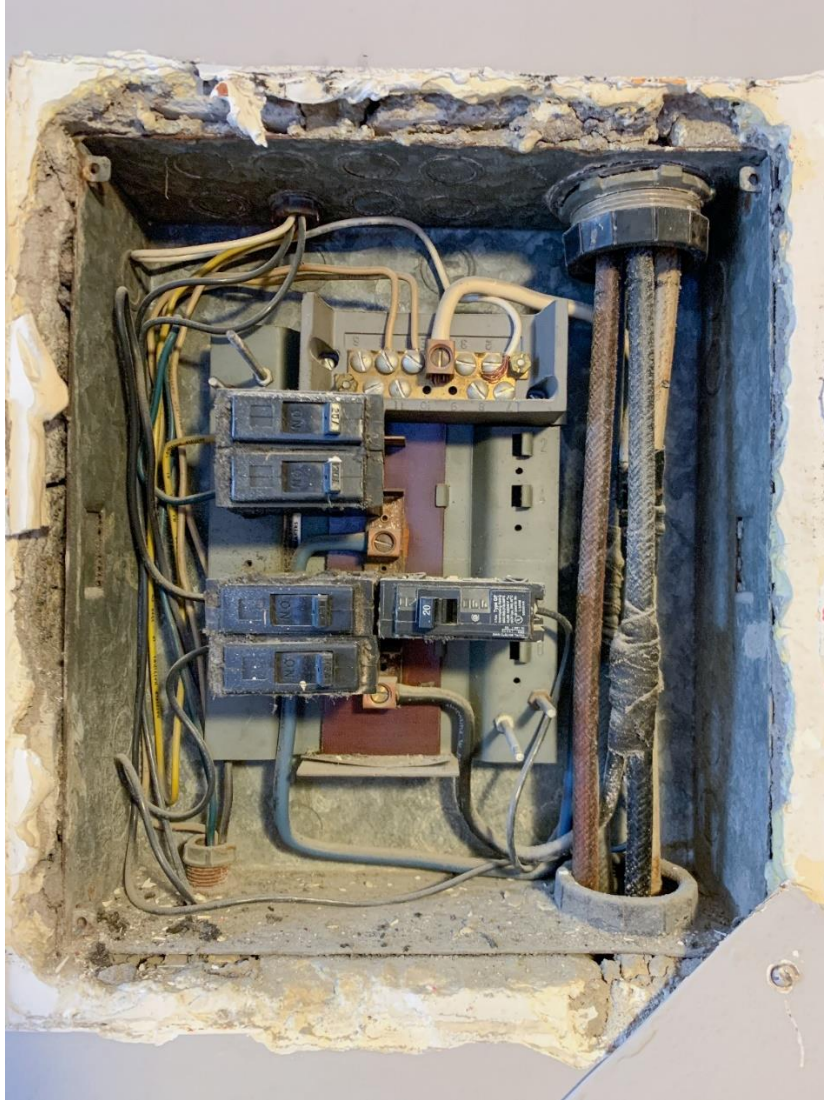
Slika 4. Primjer loše izrade elektroormara i nepridržavanje standarda.
