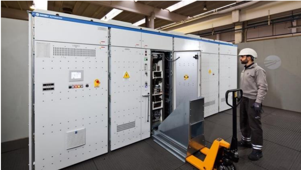
Slika 1. Primjer industrijskog elektroormara.
