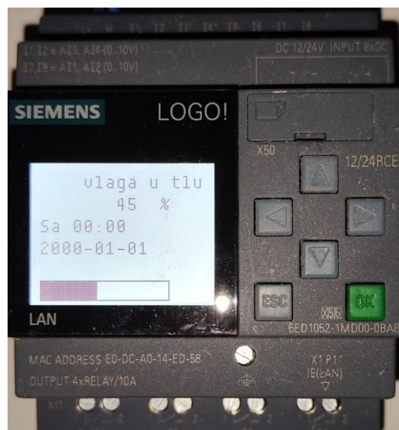
Slika 24: Prikaz podataka na logičkom kontroleru
