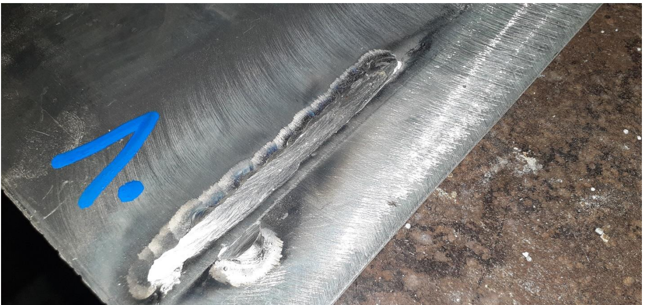
Slika 9. Ostaci zavarenog spoja
