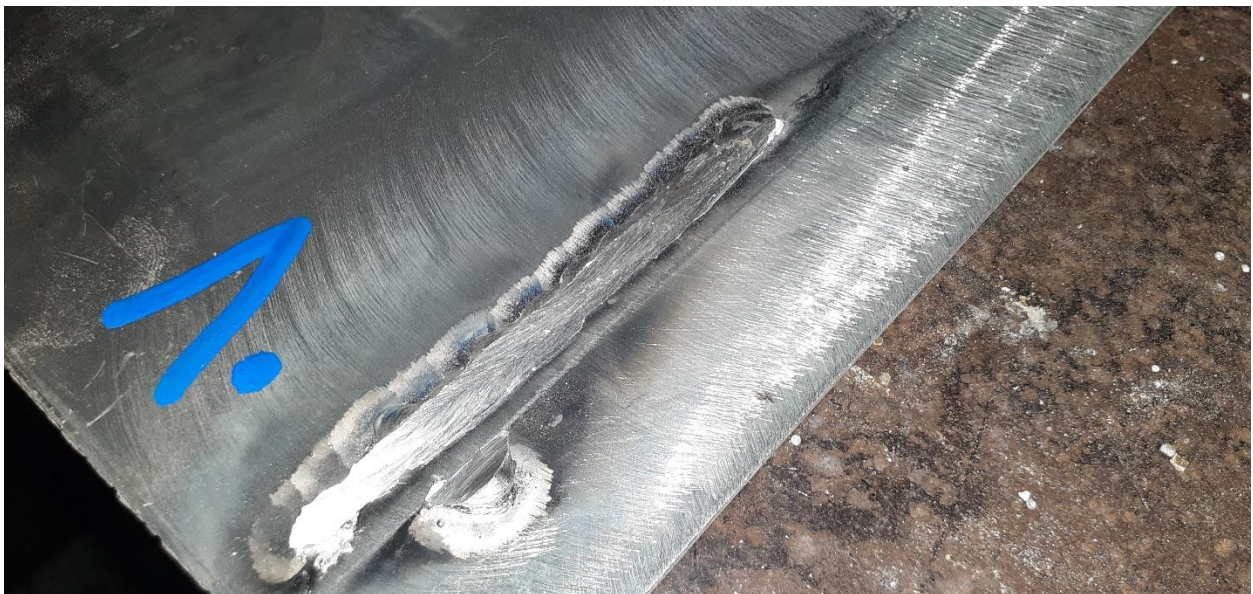
Slika 9. Ostaci zavarenog spoja
