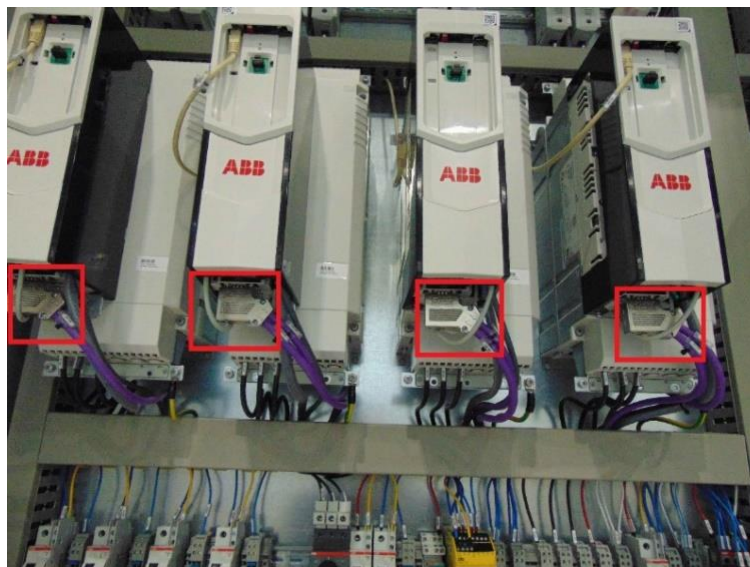
Slika 15. Spajanje VFD-a u PROFIBUS mrežu šivanjem (izvor: autor, 3.1.2021.)
