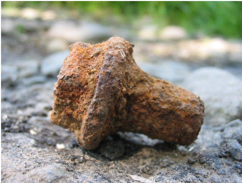
Slika 5. Primjer opće korozije vijka
