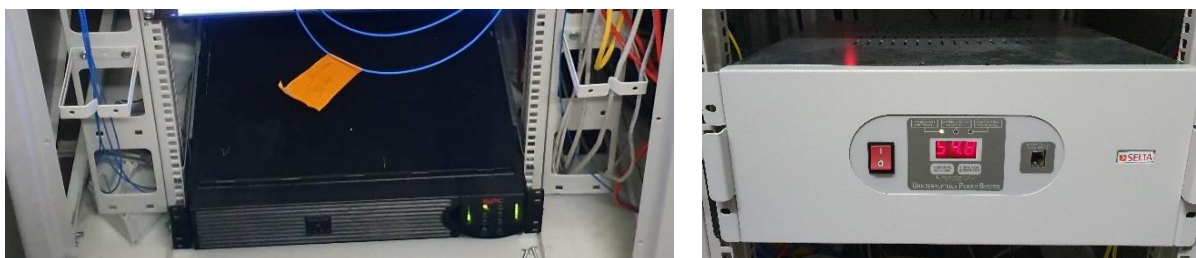
Slika 22: „UPS i energetska stanica od 48V“
