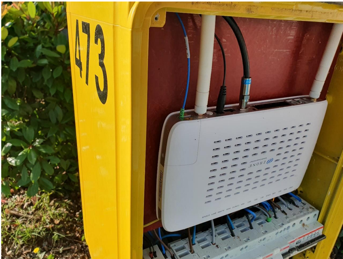
Slika 27: „ONT uređaj smješten u kamp ormariću“
