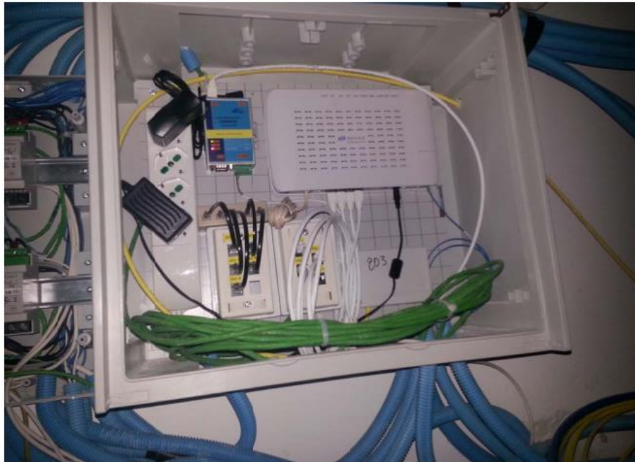
Slika 24: „ONT kabliranje u bungalovu“
