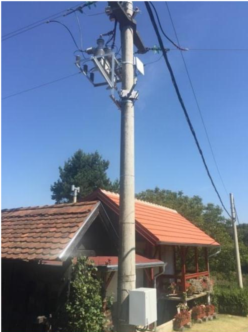
Slika 21: Smart recloser s upravljačkim ormarom
