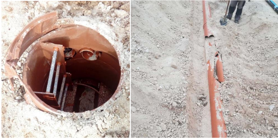
Slika 27: oštećenja cjevovoda (izvor: autor)
