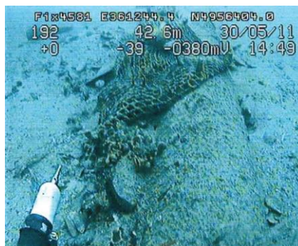
Slika 34. Prikaz oštećenja plinskih podvodnih cijevi [48]
