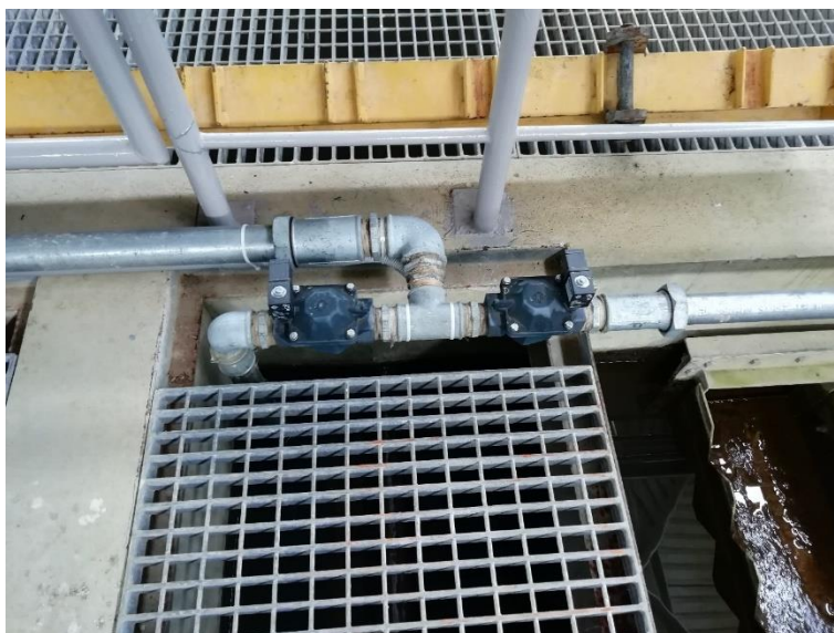
Slika 30: Elektromagnetski ventili koja otvaraju i zatvaraju dovod vode na sapnice [Autor]
