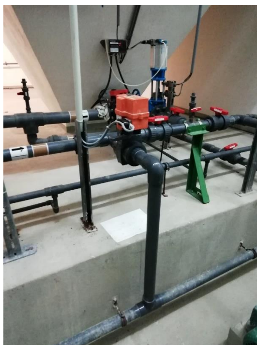
Slika 31: Elektromagnetni ventil na dnu pločastog taložnika [Autor]
