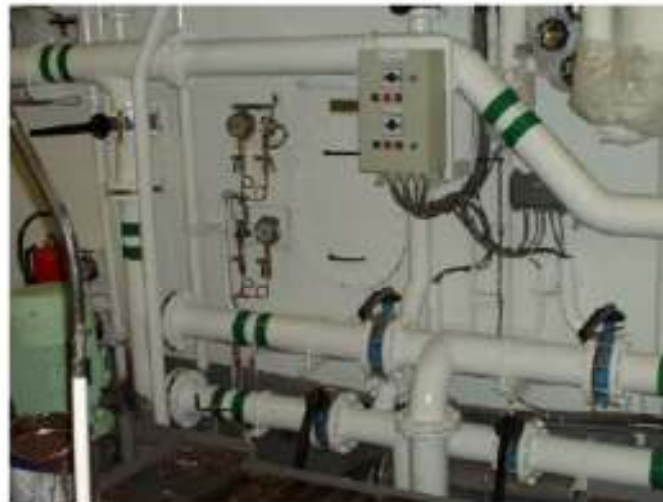
b) Cijevi za morsku vodu
