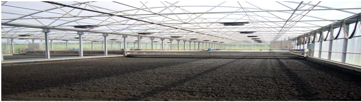
Slika 8. Postrojenje za solarno sušenje mulja
