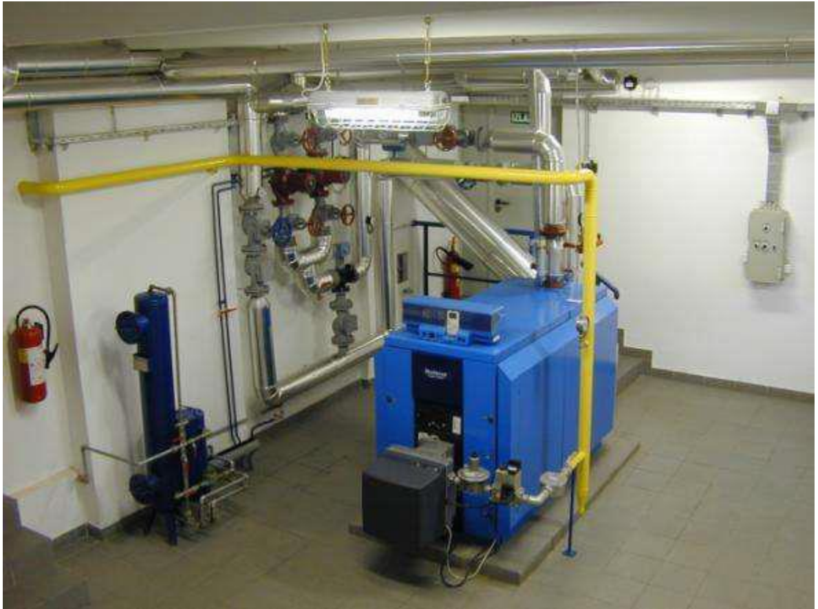
Slika 4. Izgled moderne kotlovnice
