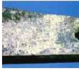
Slika 12. Prikazuje bijelu koroziju [6]
