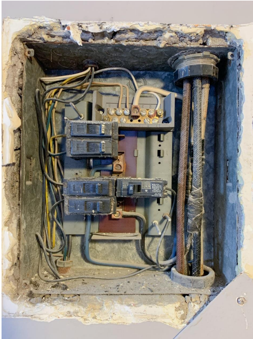
Slika 4. Primjer loše izrade elektroormara i nepridržavanje standarda.
