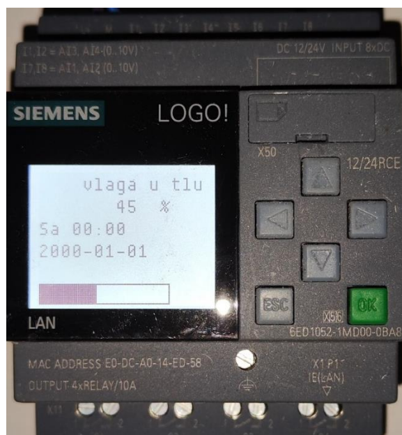
Slika 24: Prikaz podataka na logičkom kontroleru
