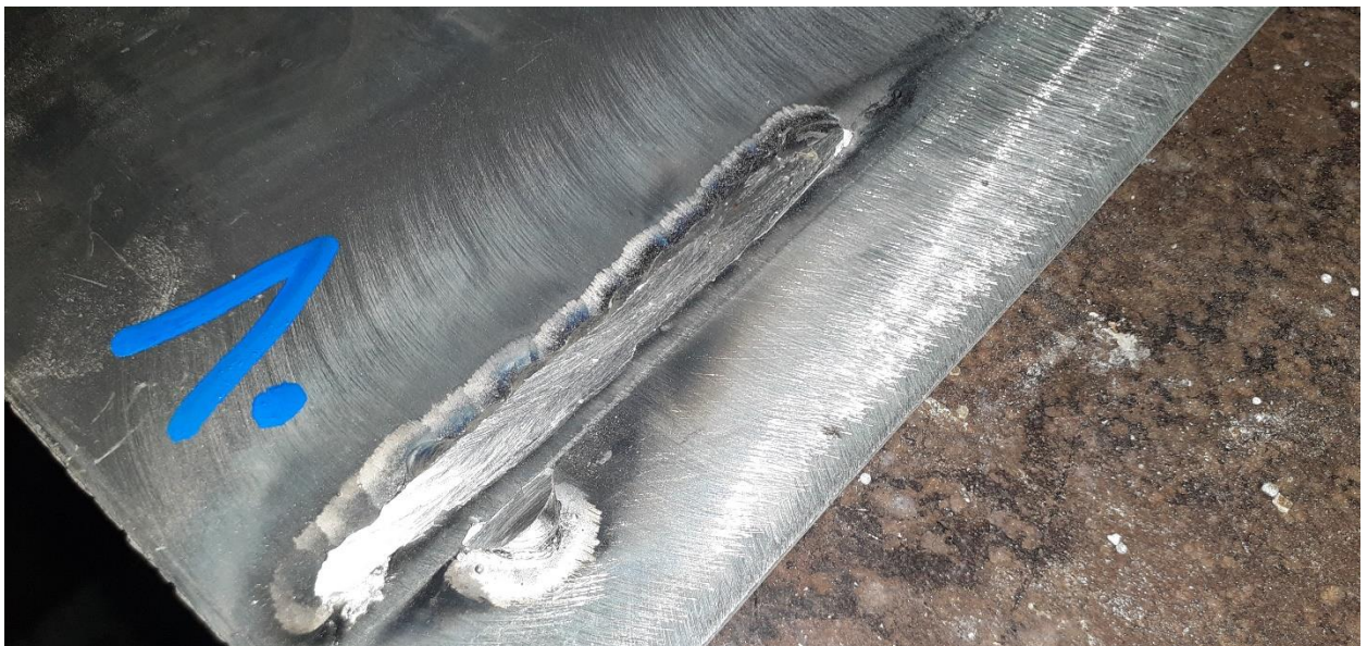
Slika 9. Ostaci zavarenog spoja
