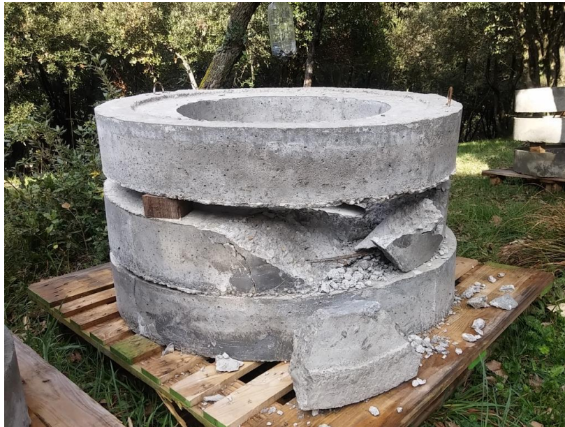
Slika: 21. Betonski rasteretni prstenovi (Izvor: autor)
