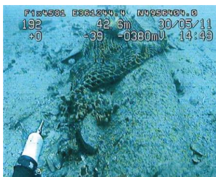
Slika 34. Prikaz oštećenja plinskih podvodnih cijevi [48]
