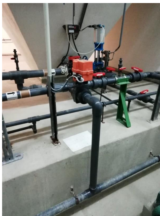
Slika 31: Elektromagnetni ventil na dnu pločastog taložnika [Autor]
