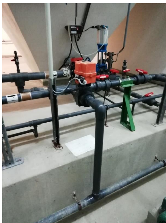
Slika 31: Elektromagnetni ventil na dnu pločastog taložnika [Autor]
