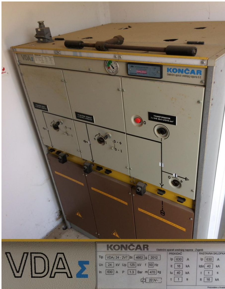
Slika 16. Izgled Končarovog SN bloka te njegove karakteristike. (Izvor: Autor.)
