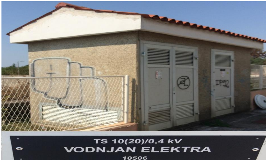
Slika 15. Izgled zidane trafostanice te njen naziv. (Izvor: Autor.)
