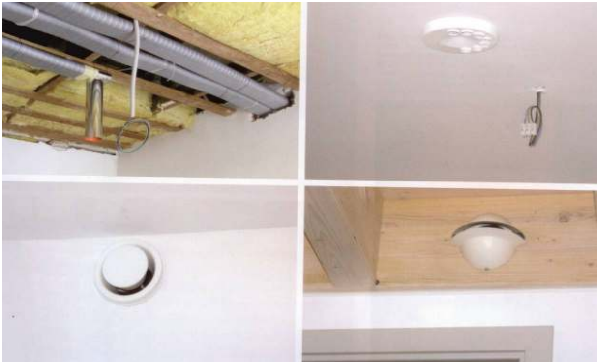
Slika 23. Kanali i mlaznice za ventilaciju
