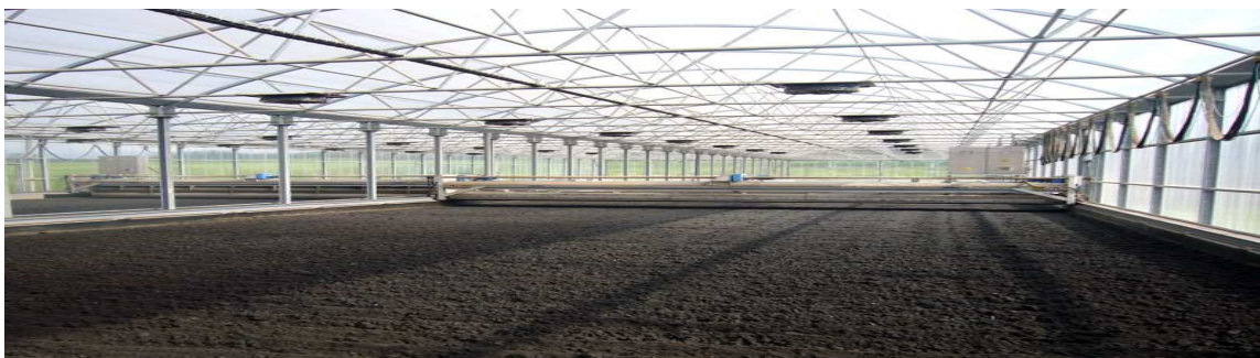
Slika 8. Postrojenje za solarno sušenje mulja
