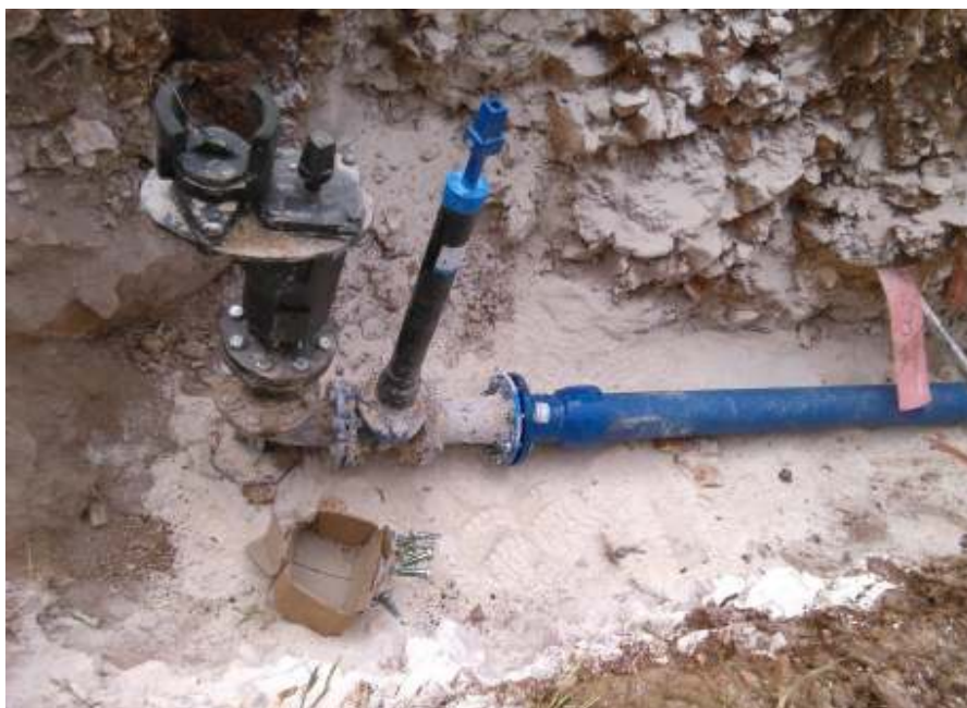
Slika 6.5.5. Kraj 4. čvora vodovodne mreže sa podzemnim hidrantom [3]
