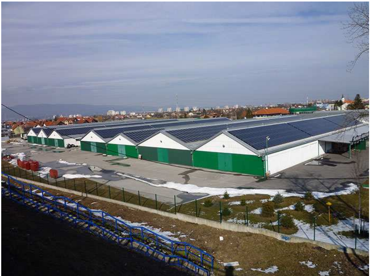
Slika 7.2.3 Solarna elektrana Petrokov; Izvor: www.geo-solar.hr
