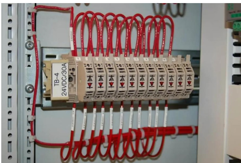
Slika 9. Dobra izvedba spajanja komponenti u elektroormaru.
