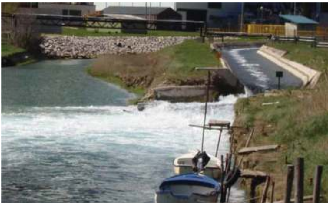
Slika 13: Ušće otvorenog izljevskog kanala u rijeku Boljunčicu
