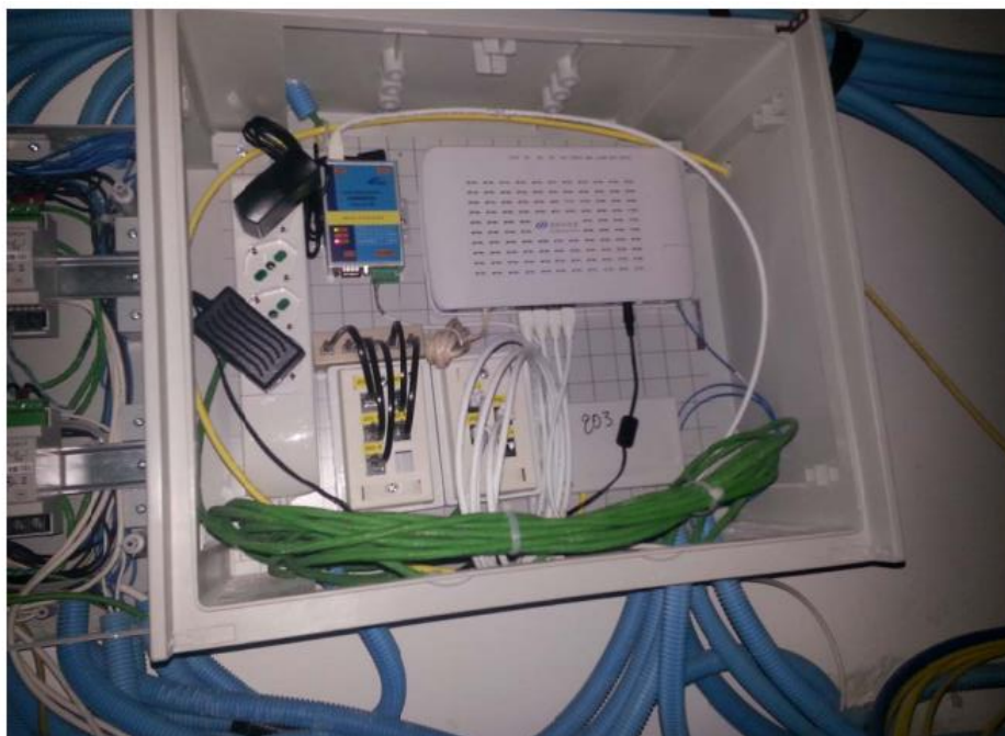
Slika 24: „ONT kabliranje u bungalovu“
