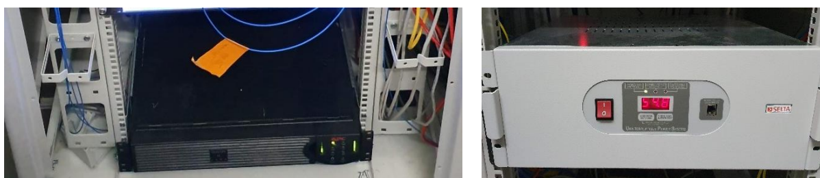
Slika 22: „UPS i energetska stanica od 48V“
