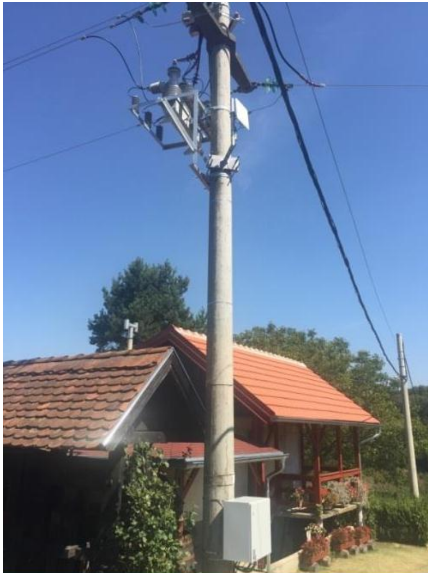
Slika 21: Smart recloser s upravljačkim ormarom
