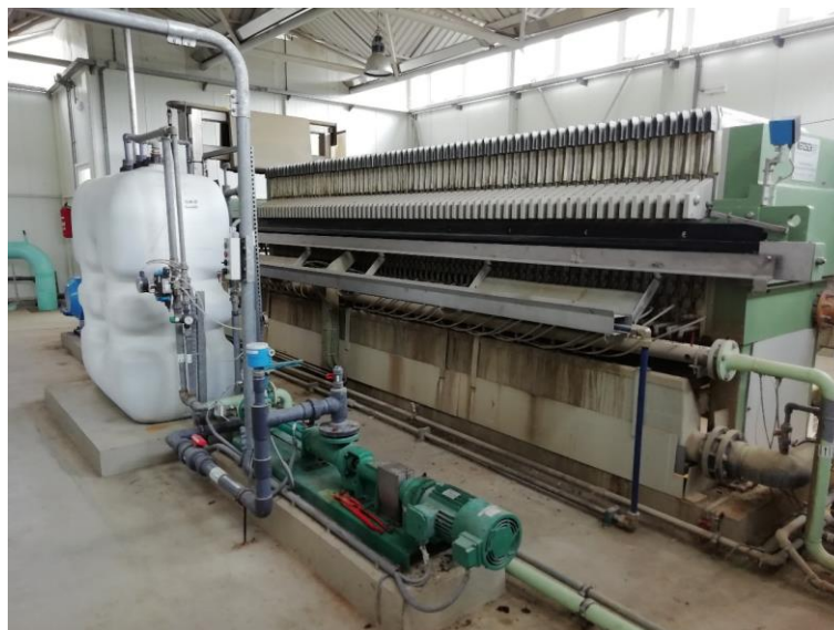
Slika 10: Pumpa za mulj i filter preše [Autor]
