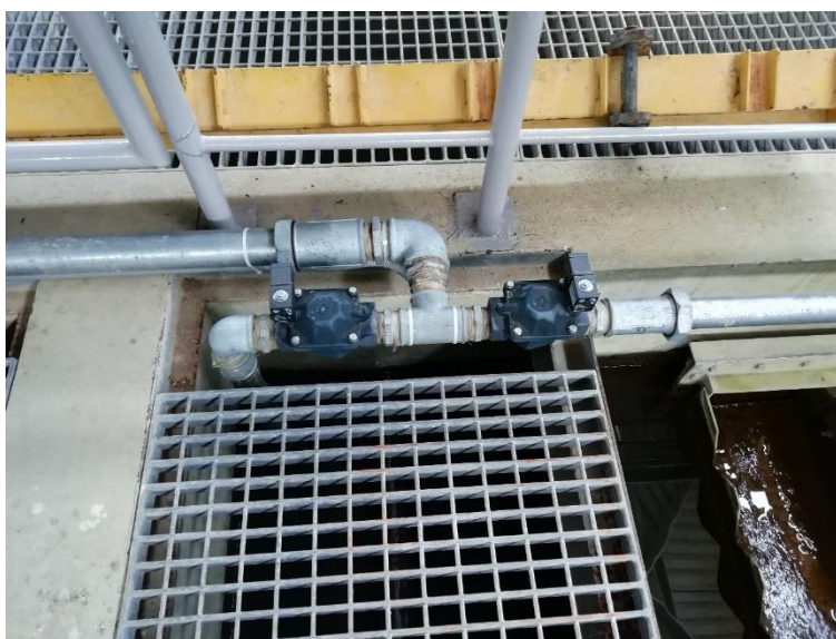
Slika 30: Elektromagnetski ventili koja otvaraju i zatvaraju dovod vode na sapnice [Autor]
