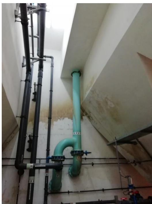
Slika 22: Cijevi za odvod izbistrene vode s mogućnošću odabira za povratak u proces kondicioniranja ili slanja u recipijent [Autor]
