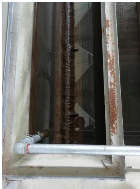
Slika 29: Vertikalna vodovodna cijev na obodu taložnika [Autor]
