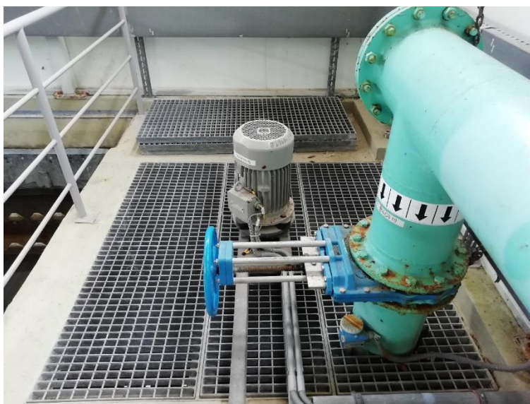
Slika 20: Dovod vode u flokulacijski bazen, zasunski ventil i miješalo [Autor]
