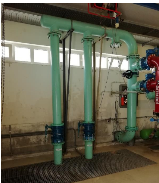
Slika 17: Cijevi za dovod vode od pranja filtera na taložnik [Autor]
