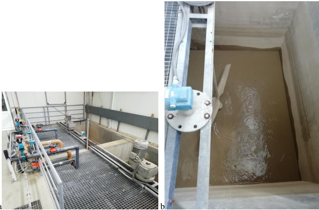
Slika 9: Spremnici za prihvatanje mulja a) pogled na spremnik, b) mješač u spremniku mulja [Autor]
