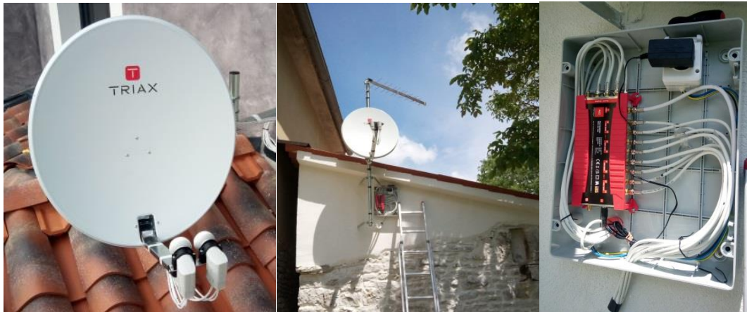
Slika 33: Primjer ugradnje koaksijalnog 9/6 multiswitcha
